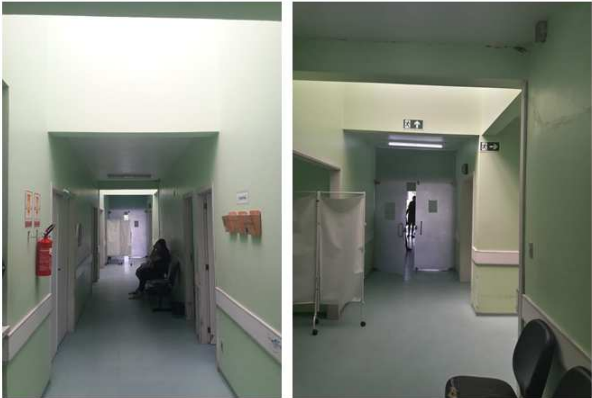
Figura 6 – Sinalização da rota de fuga (a) antes e (b) depois
