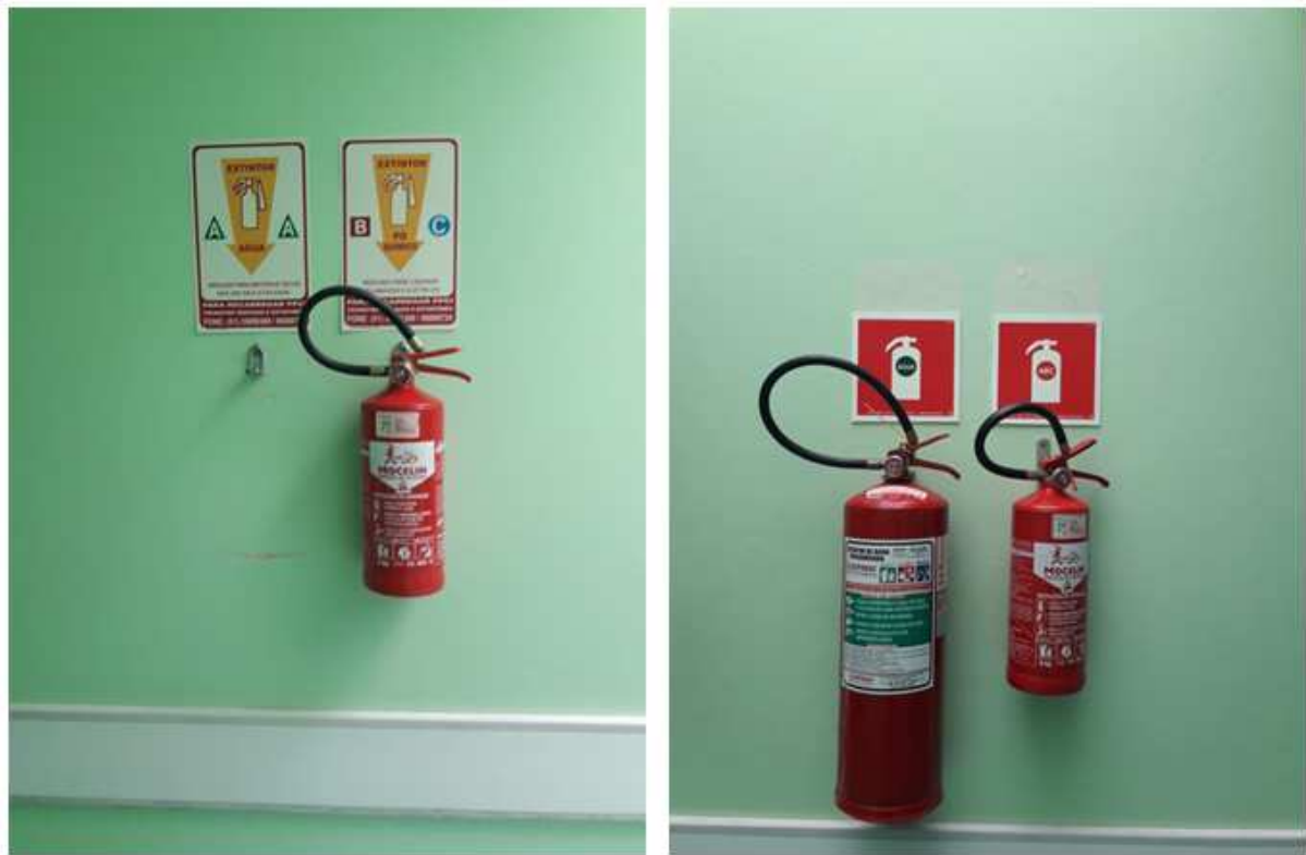
Figura 3 – Extintor (a) antes e (b) depois
