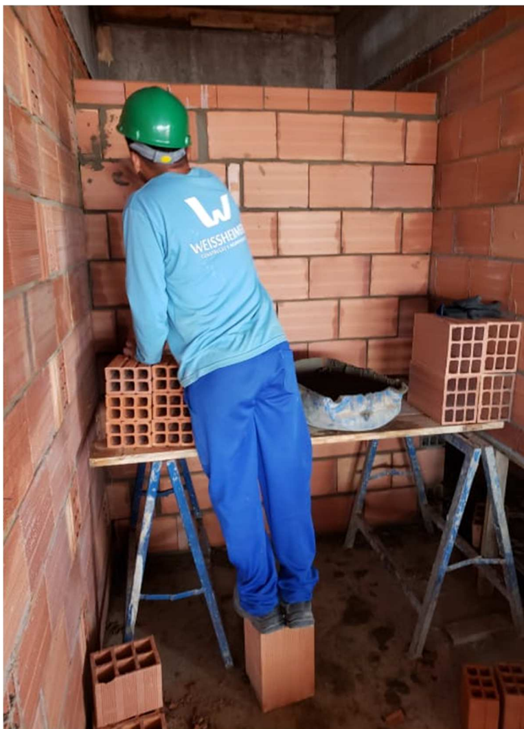
Figura 2. Situação onde observa-se o emprego de um tijolo pelo funcionário, como improvisado, para execução de seu trabalho.
