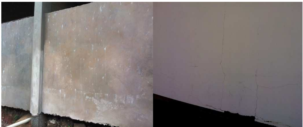
Fotos 3 e 4: Eflorescência generalizada em revestimento ainda não finalizado (esquerda) e fissuras com descolamento (direita)
