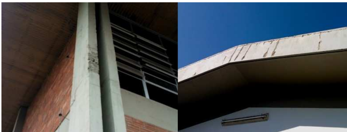
Foto 5 e 6: Ninho de concretagem (esq.) e corrosão de armadura com deslocamento do concreto (dir.)
