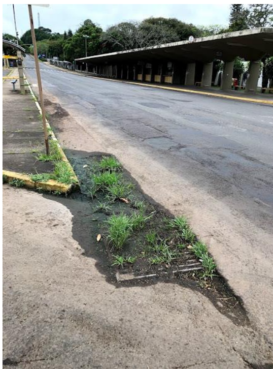
Fotografia 7 – Boca de lobo completamente obstruída
