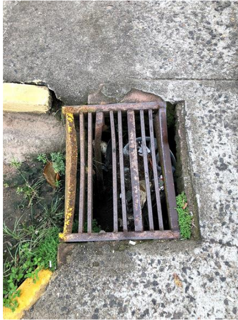
Fotografia 3 – Boca de lobo situada em frente a Fotografia 2
