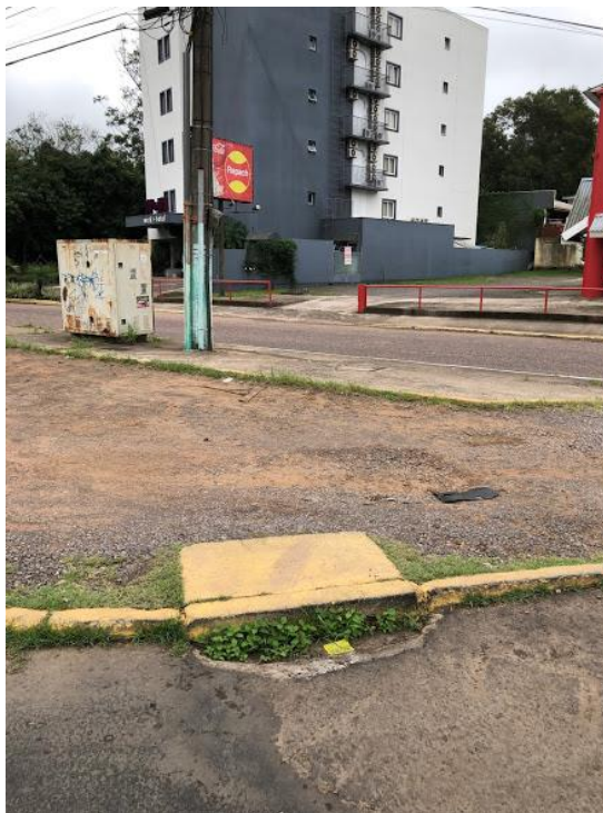
Fotografia 6 – Boca de lobo aparentemente obstruída
