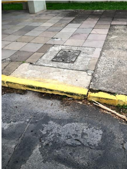
Fotografia 9 – Boca de lobo praticamente fechada
