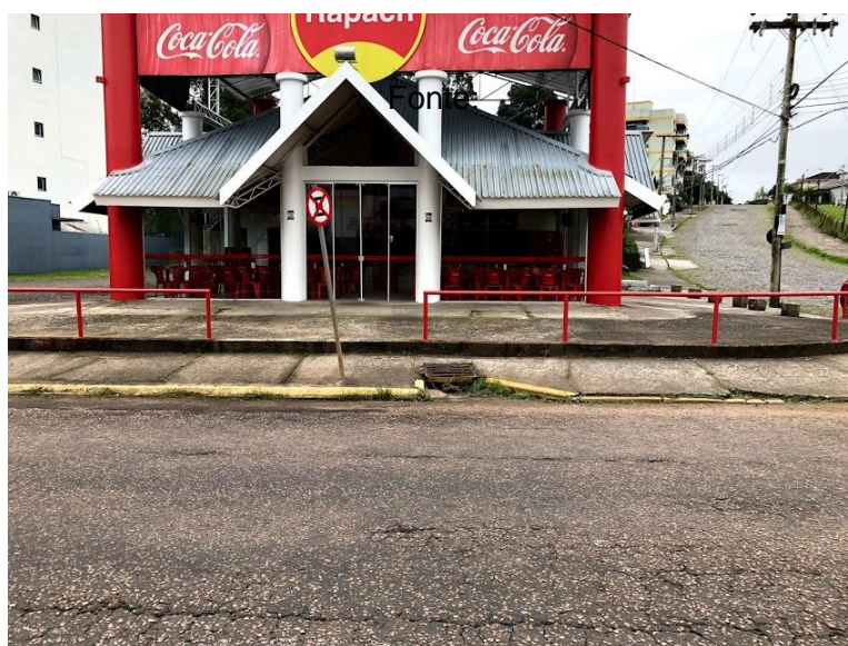
Fotografia 2 – Local onde mais se concentra o problema
