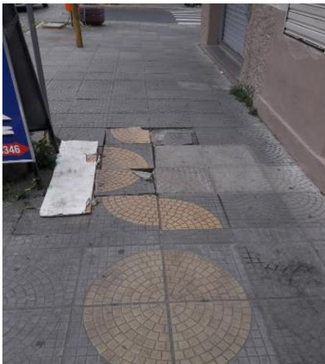
Figura 21 - Presença de buraco no segmento S2
