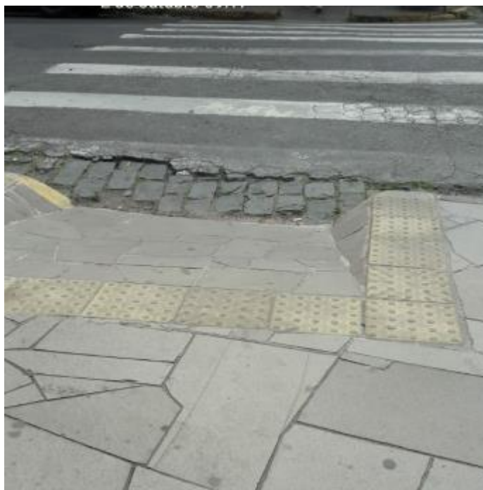
Figura 28 - Rampa com inclinação inadequada
