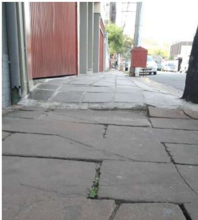
Figura 22 - Presença de desnível no segmento S12
