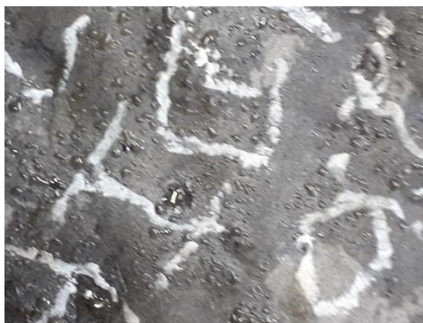
Figura 14 - Amostra com absorção de umidade
