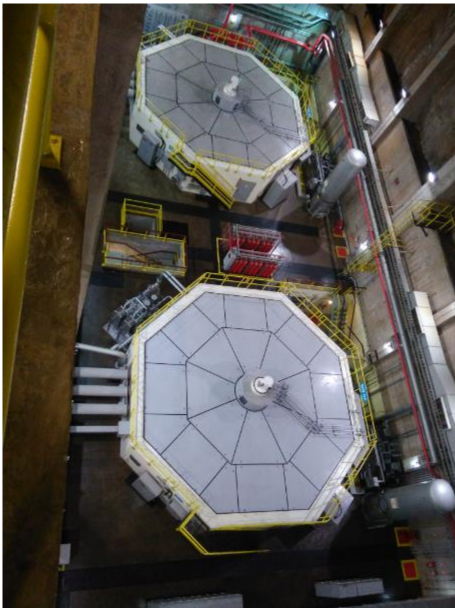
Figura I- 5 – Vista panorâmica da casa de máquinas da usina Monte Claro
