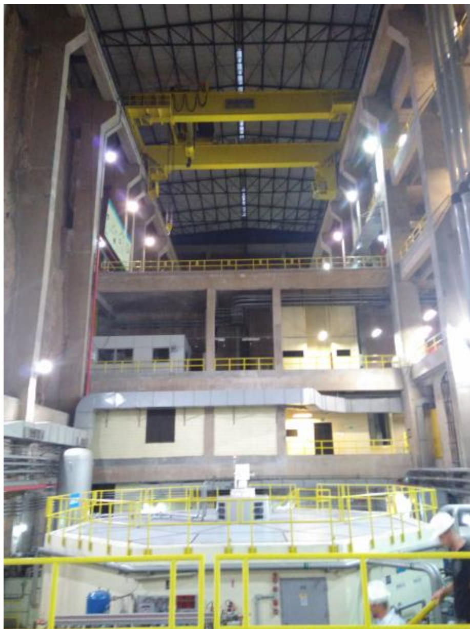
Figura I- 4 – Casa de máquinas da usina Monte Claro
