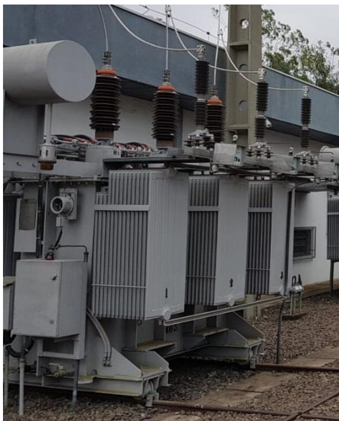
Fotografia 5 – Transformador de Potência SC1
