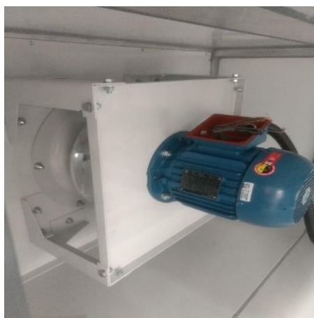
Figura 20 – Montagem de ventilador do tipo plenum fan de acoplamento direto em uma UTA.
