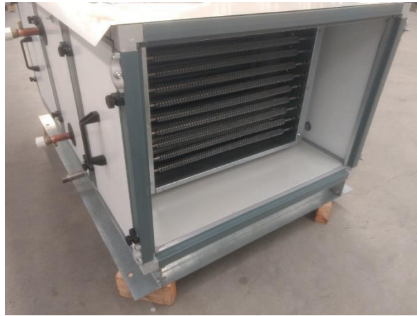
Figura 17 – Resistências elétricas para aquecimento do ar instaladas em uma UTA.
