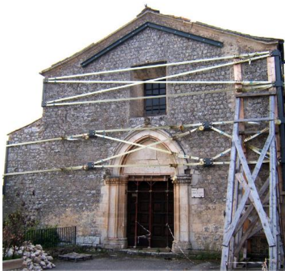
Figura 9 – Fachada de edificação histórica após terremoto
