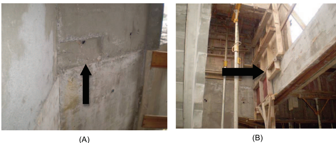
Figura 26 – (A) P15 com falhas. (B) Fôrmas dos P9 e P15.
