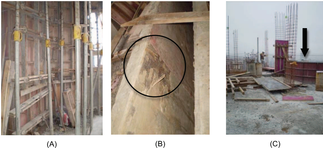
Figura 30 – (A) Fôrmas sem Paginação. (B) Desgaste das Fôrmas. (C) Fôrma Metálica.
