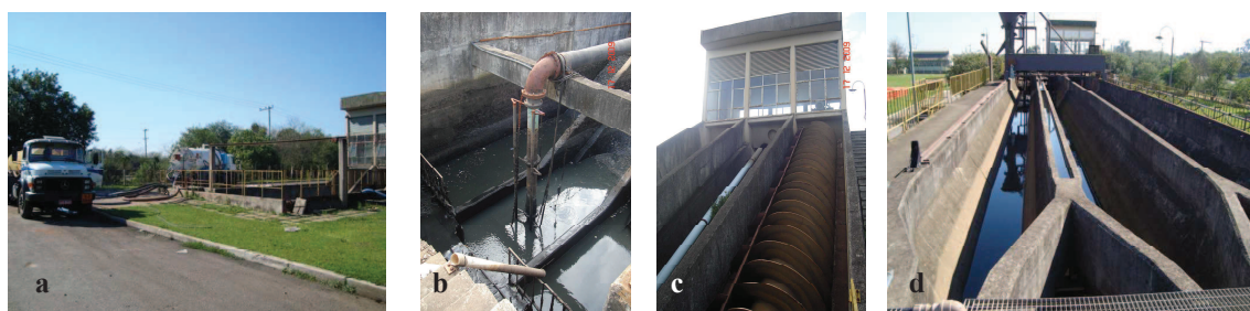
Figura 5.2: Tratamento Preliminar da ETE Canoas – CORSAN. (a) Câmara de reservação inferior. Caminhões tanque descarregando efluentes externos. (b) Detalhe da bomba submersa. (c) Sistema de recalque do afluente. (d) Caixa de areia.
