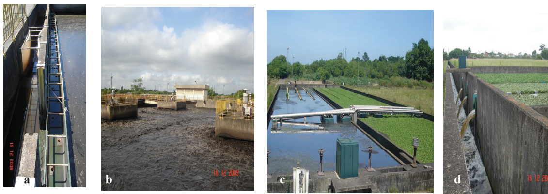
Figura 5.4: Tratamento Biológico da ETE Canoas – CORSAN. (a) Detalhe da calha de entrada do tanque de aeração, através da qual o efluente é conduzido lentamente para o fundo do tanque de aeração. (b) Reator Biológico. Aeradores em funcionamento. (c) Decantadores Secundários. (d) Detalhe da saída do efluente final, sendo encaminhado para o corpo receptor.
