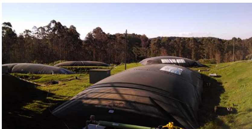
Figura 3.19 – Bolsas onde o biogás é armazenado.
