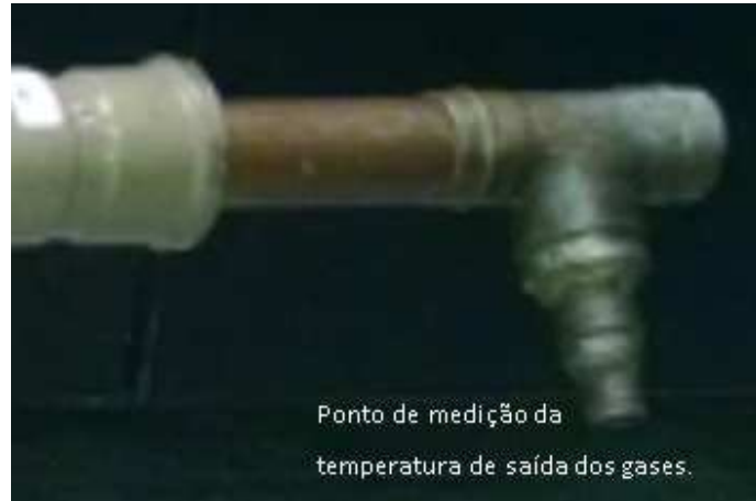
Figura 3.15 – Verificação da temperatura de saída dos gases no trocador de calor.
