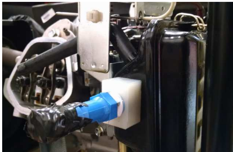
Figura 3.24 – Conexão de alimentação de biogás fechada para utilização a gasolina.
