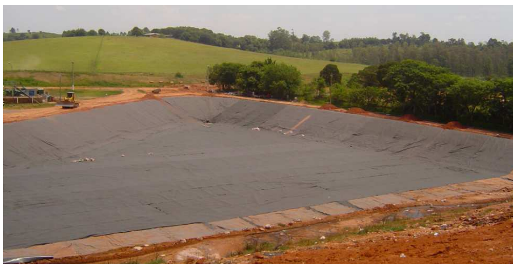
Figura 1 – Construção de uma célula de resíduos no Aterro Sanitário de São Leopoldo/RS.
