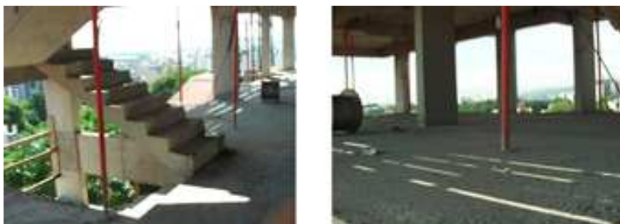
Figura 15 e Figura 16: falta de proteção coletiva
