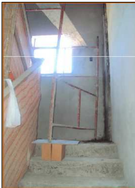
Figura 6: situação de risco de acidente em obra. Fonte: SL Consultoria
