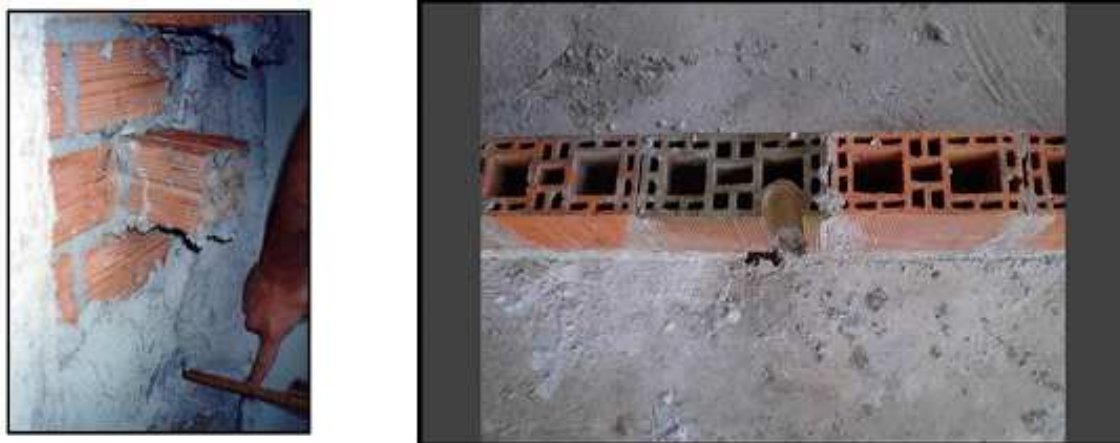
Figura 1 e Figura 2: Consumo excessivo de argamassa para revestimento
