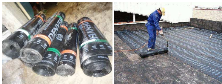
Figura 050 – Imagem da Manta Asfáltica
