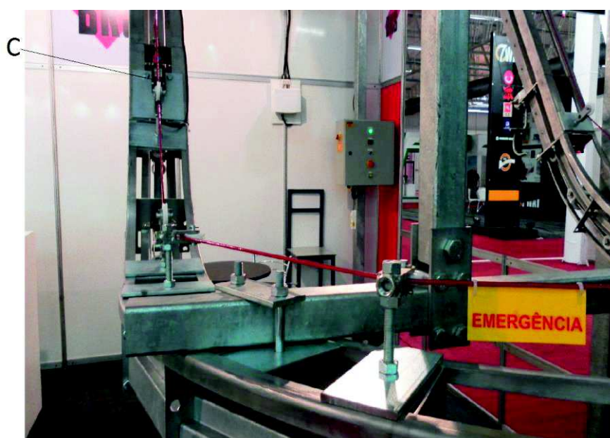
Figura 5: Vista da chave de segurança por cabo de aço com identificação de emergência.
