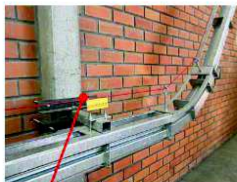
Cabo de emergência que deve ser instalado em pontos onde o transportador estiver em altura inferior a 2,5m em relação ao plano de trabalho
