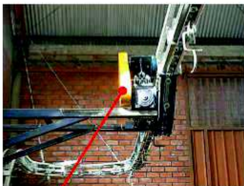
Proteção fixa do mecanismo de transmissão de força
