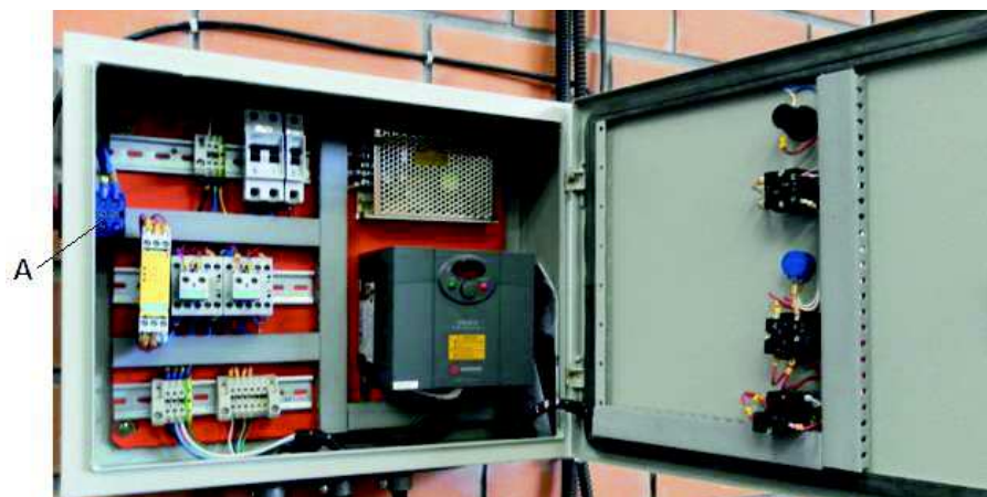
Figura 2: Quadro de comando aberto
