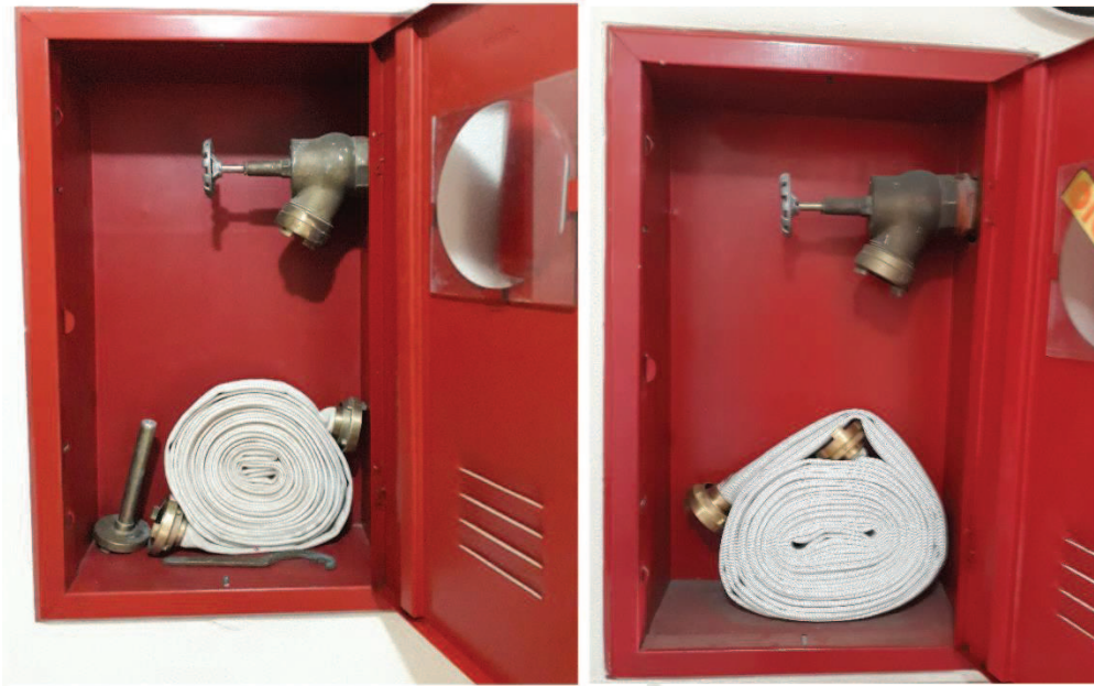
Figura 4 – Abrigo de hidrantes
