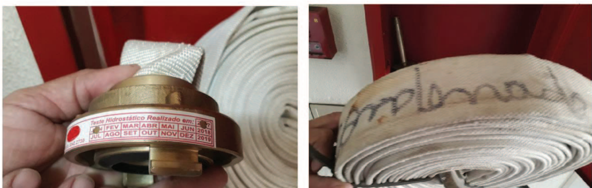
Figura 5 – Mangueiras de hidrantes
