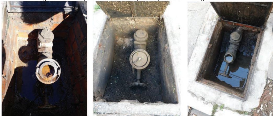
Figura 10 – Dispositivo de recalque no passeio – imagens do local
