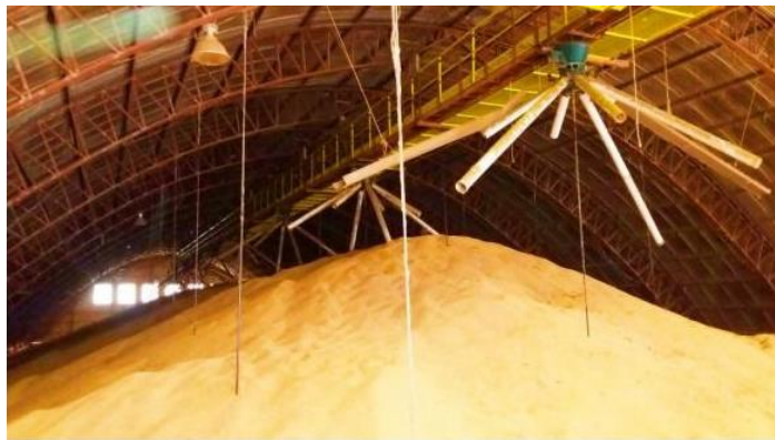
Figura 27 – Distribuidor de grãos em um silo graneleiro
