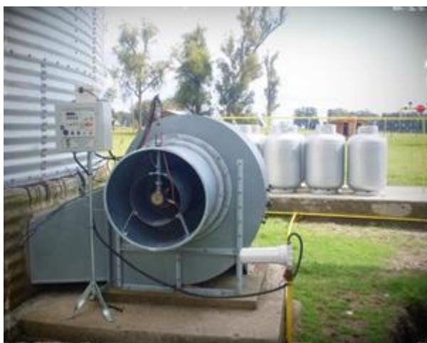
Figura 28 – Ventilador com queimador a GLP
