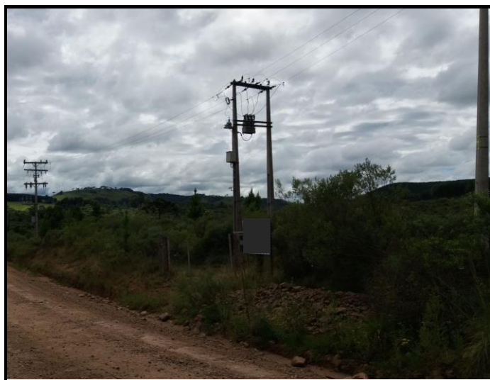
Figura 10 - Foto do ponto de ligação entre a rede de distribuição externa e a rede local
