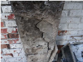
Figura 6 -Foto de queda revestimento
