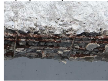
Figura 11 - posição inadequada da armadura
