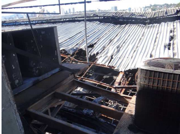
Figura 4 - Foto da cobertura deformada
