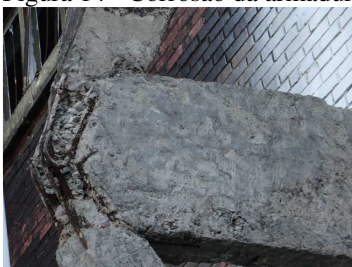
Figura 14 - Corrosão da armadura
