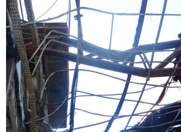
Figura 5- Foto da tesoura metálica deformada
