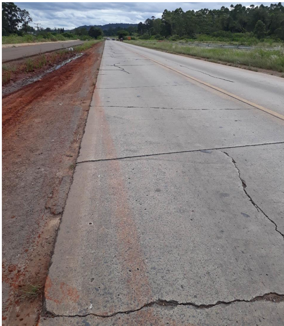
Fotografia 2 - Fissuras horizontais e verticais na placa de concreto
