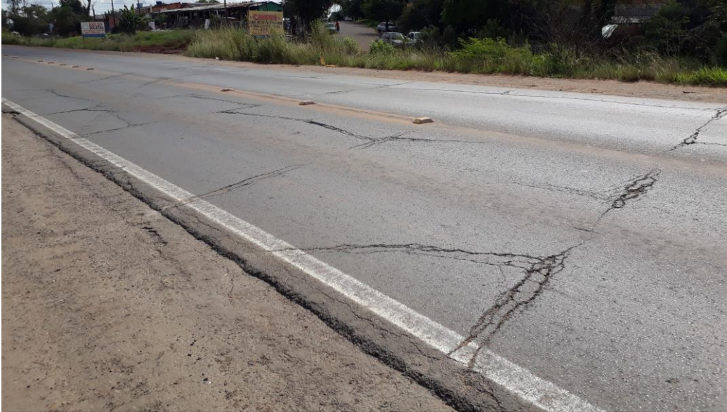
Fotografia 3 - Fissuras horizontais e verticais no revestimento asfáltico
