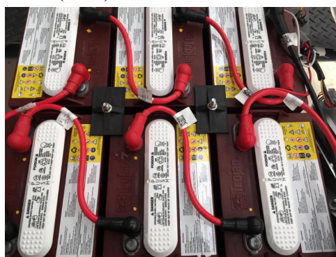
Figura 5: Banco de baterias (48 V) utilizado no veículo elétrico da marca Tramontina.
