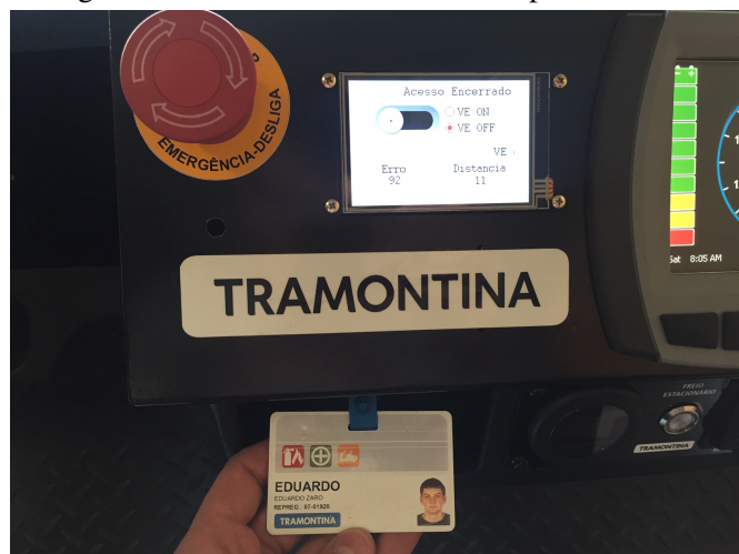
Figura 57: Leitor RFID instalado no painel do VE.
