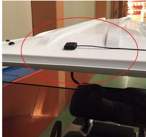
Figura 54: Instalação da antena externa do GPS no teto do veículo.
