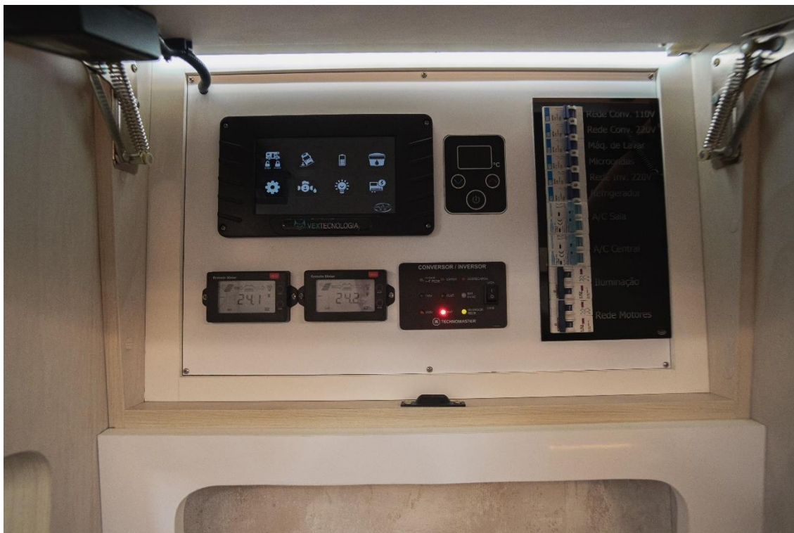
Fotografia 9 – Painel de controle e quadro geral de disjuntores
