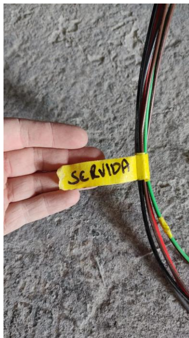
Fotografia 3 – Identificação de condutores
