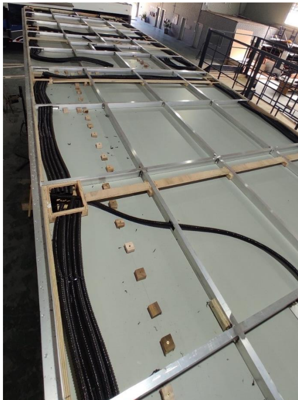
Fotografia 4 – Caixas de passagem e eletrodutos no teto
