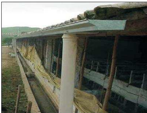
Figura 8: Granja com canaletas externas e coletores de água no telhado.
