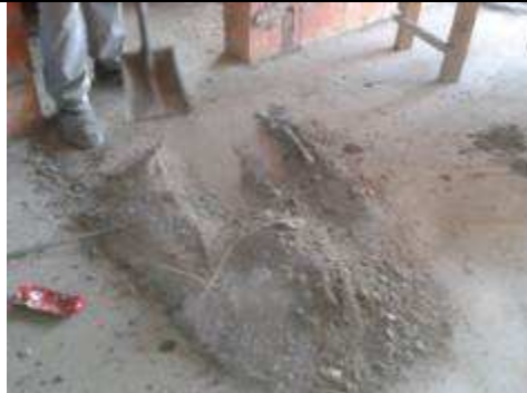
Figura 8: Resíduos de reboco do teto junto a lascas de madeira e geração de poeira.
