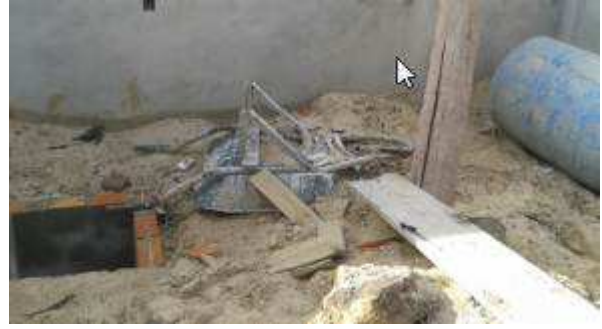
Figura 7: Equipamento obsoleto junto a sobras de madeiras depositadas em local não adequado para esse fim.
