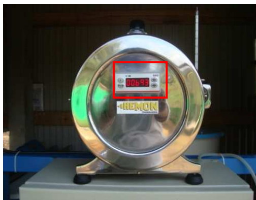
Figura 8 – Medidor de vazão do biogás.
