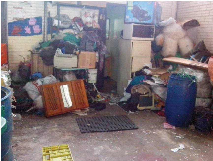
Figura 10. Acesso aos banheiros, nos fundos do galpão centro. Ainda depositam diversos materiais para uso pessoal.
