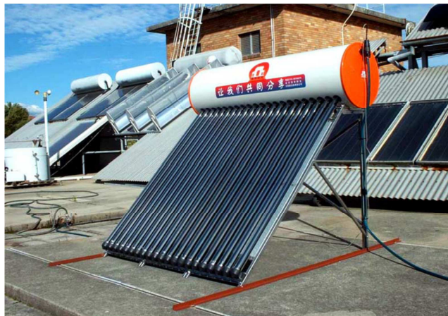
Figura 2.6 – Sistema de aquecimento de água por coletor solar.
