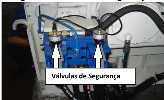
Figura 10 – Válvulas de segurança
