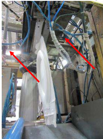
Figura 8 – Dutos de ar para refrigeração
