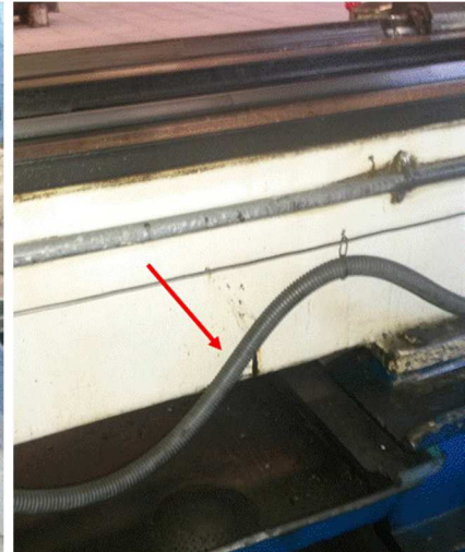
Figura 16 – Mangueiras que possibilitam o ciclo fechado do fluido de corte
