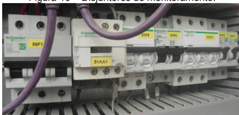
Figura 16 – Disjuntores de monitoramento.
