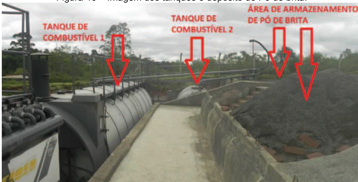
Figura 46 – Imagem dos tanques e depósito de Pó de brita.
