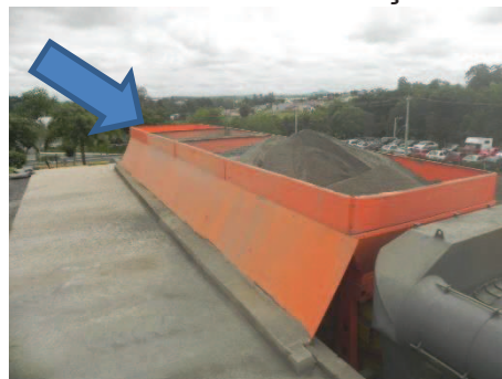
Figura 4 – Área de alimentação dos silos
