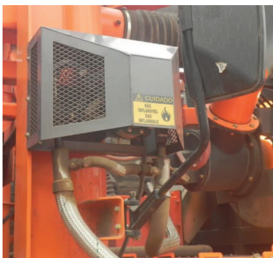
Figura 27 – Proteção no sistema de gás.
