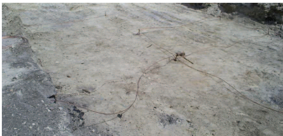
Figura 11 – Aterramento da Usina.
