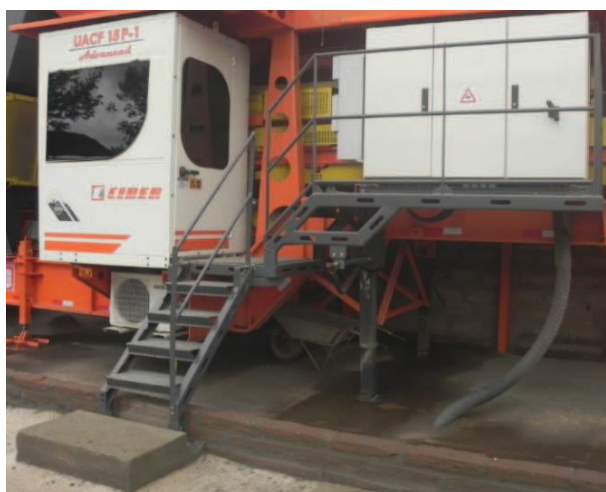
Figura 36 – Escada de acesso à Cabine e ao Painel elétrico.
