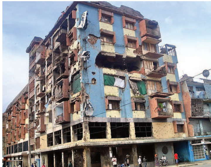
Fotografia 2: Angola destruída pela Guerra. Fonte: Angola Xyami (2011).
