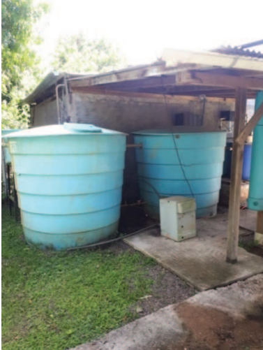
Fotografia 4 - Sistema de reservatórios para o armazenamento de esgoto
