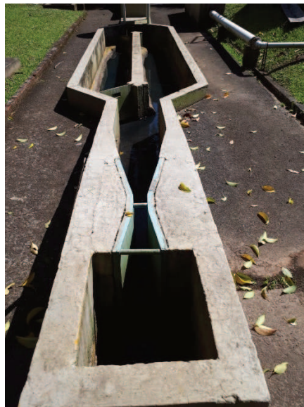
Fotografia 3 - Calha Parshall utilizada para medir a vazão de entrada no sistema de tratamento
