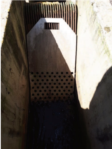
Fotografia 1 - Gradeamento para remoção de sólidos grosseiros, folhas e galhos
