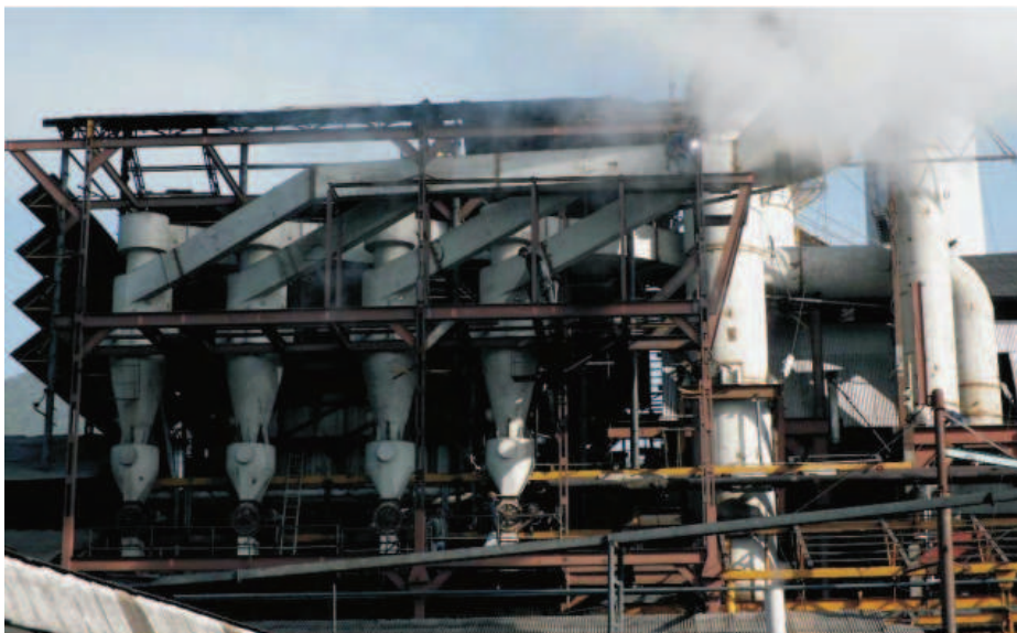
Figura 20 - Vista frontal do secador na operação em Ingenio El Carmen, México
