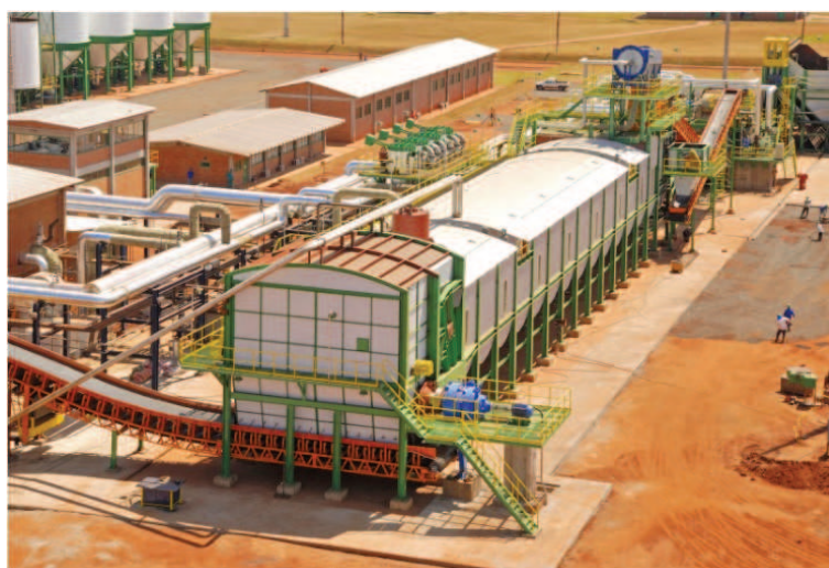
Figura 4 - Difusor de CA instalado na Usina Guariroba - Grupo Bunge
