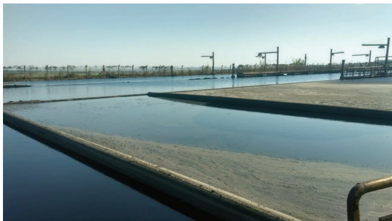
Figura 34 - Piscinas de decantação dos resíduos oriundos do lavador de gases
