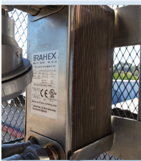
Figura 6.13 – Trocador de calor de placas do sistema de refrigeração do fluido térmico.
