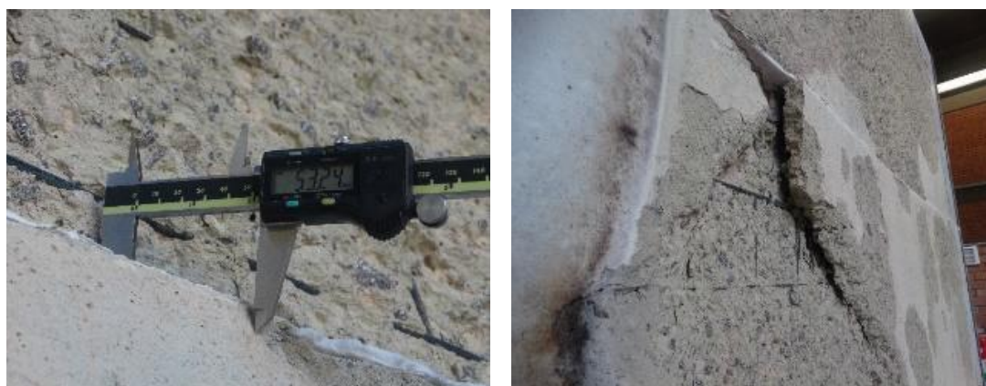
Figura 66 – BOR10% após ensaio de resistência ao fogo: (a) perda de seção média e (b) foto ampliada da superfície da amostra
