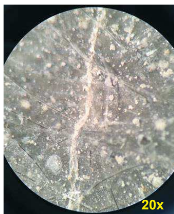
Figura 123 – Cicatrização total de trecho de fissura do PVA2,0SA no ELS quando exposto aos ciclos de molhagem e secagem
