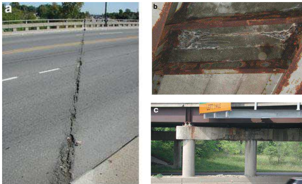
Figura 12 – Estado de conservação das juntas de dilatação em ponte após 15 anos de uso
