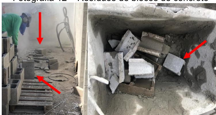
Fotografia 12 – Resíduos de blocos de concreto
