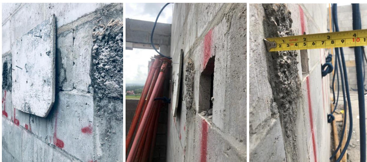
Fotografia 14 – perdas de graute nas janelas de inspeção
