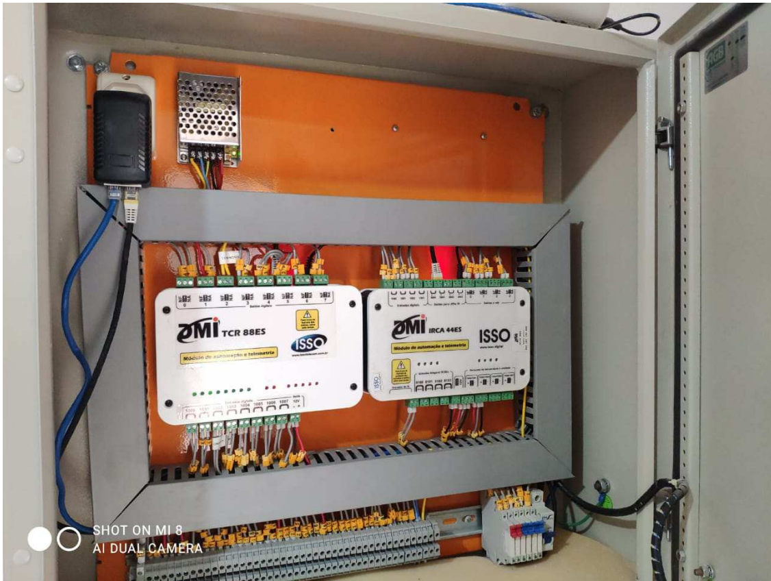
Fotografia 7 – Quadro de interligação dos equipamentos para comandos remotos.
