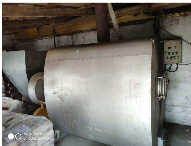
Fotografia 1 – Fornalha automatizada com alimentador e quadro comando
