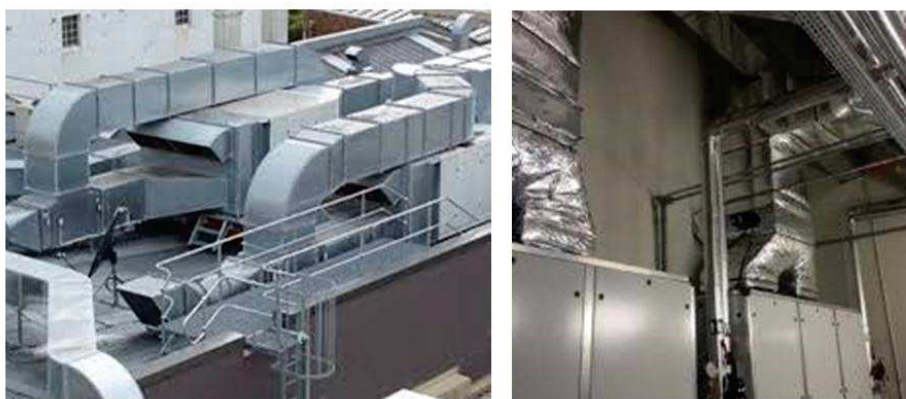
Figura 11 – Sistemas com dutos de ar condicionado HVAC
