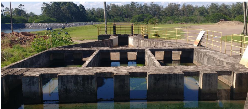
Fotografia 3 - Caixa de Areia
