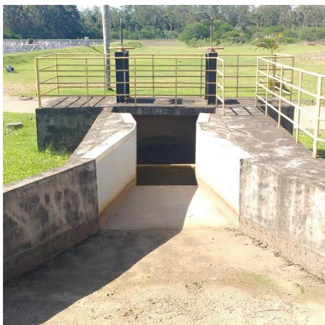
Fotografia 4 - Calha Parshall e Partidor Hidráulico
