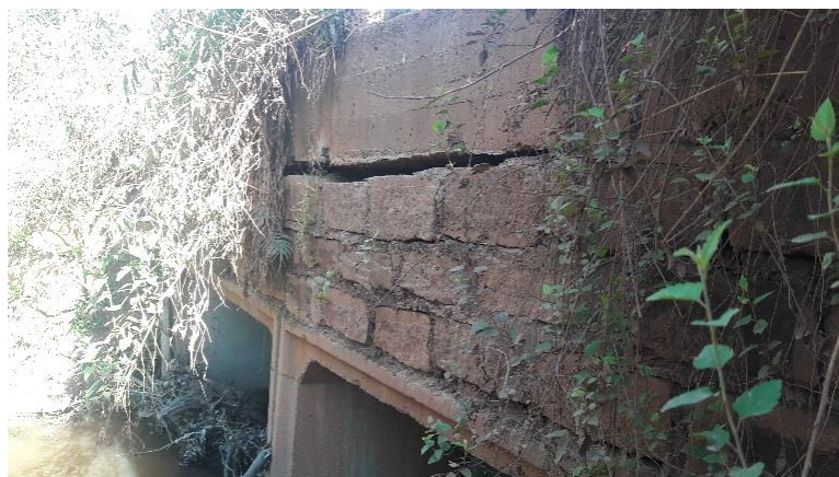
Fotografia 1 – Detalhe de patologias no bueiro nº 21
