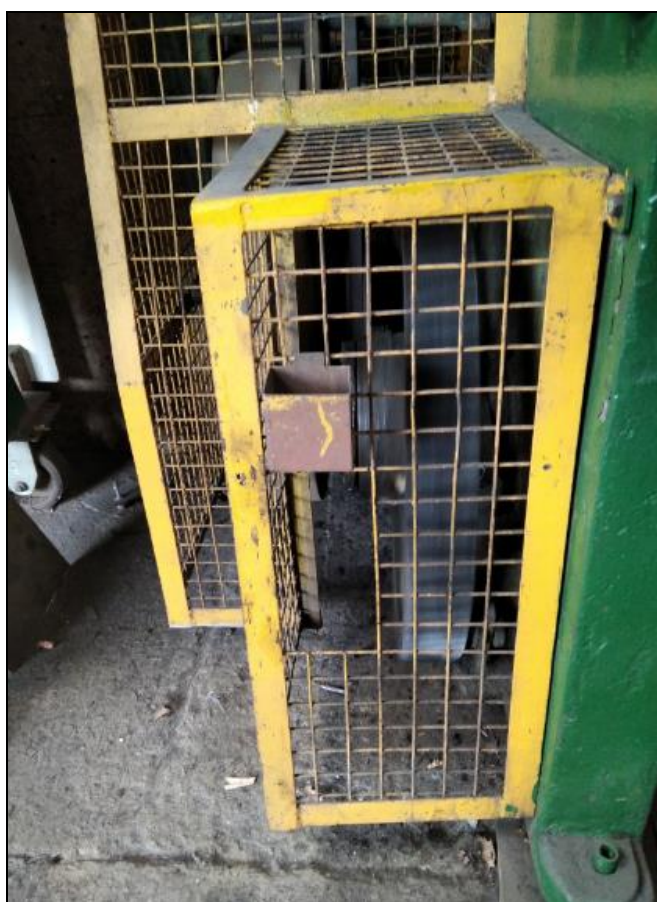
Fotografia 12 - Proteção em tela otis
