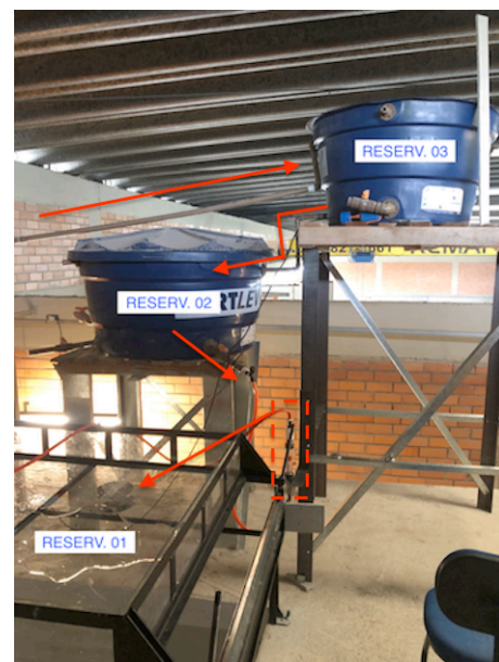
Figura 62 – Direção do fluxo de água na instalação superior
