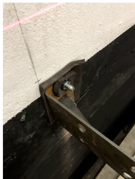
Figura 53 – Detalhe do isolamento
