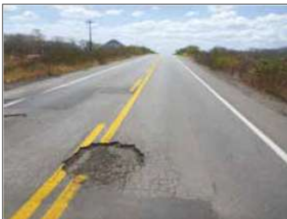
Figura 15 – Cavidade (panela) no pavimento provocada pelas ocorrências de trincas de fadiga
