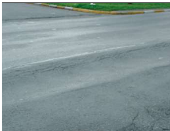
Figura 19 – Deformação plástica em trilhos de roda
