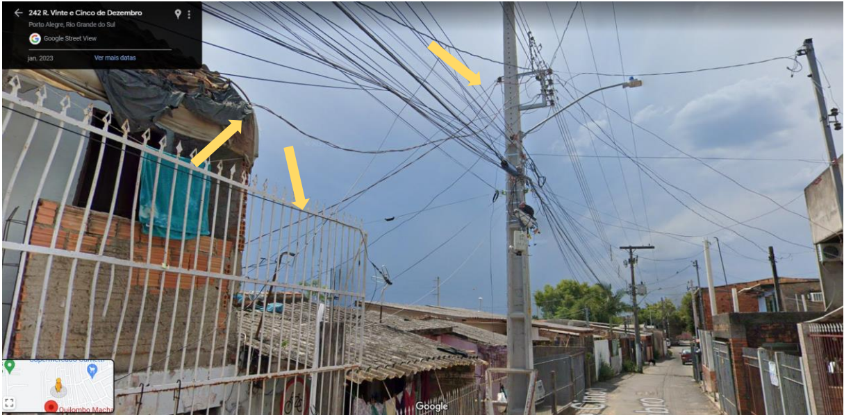
Figura 24 - Rede de distribuição com ligações irregulares Rua 25 de Dezembro
