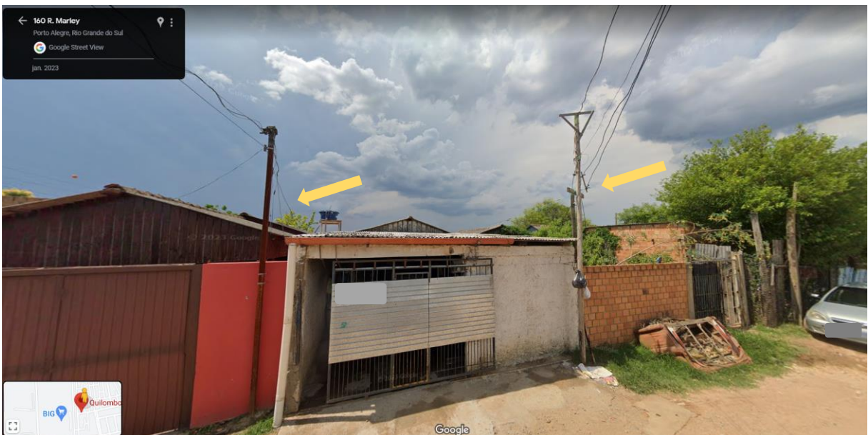
Figura 25 - Rede de distribuição com ligações irregulares Rua 25 de Dezembro
