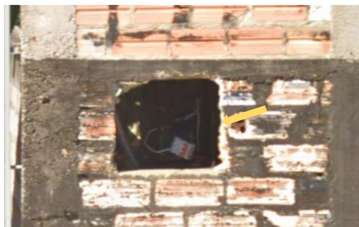
Figura 22 - Ponto de fornecimento de energia sem medição e ramal de entrada com possível adulteração (ampliada)
