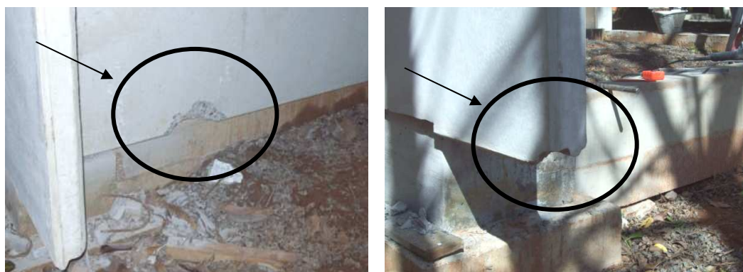
Figura 66: Quebras ocorridas no transporte dos painéis
