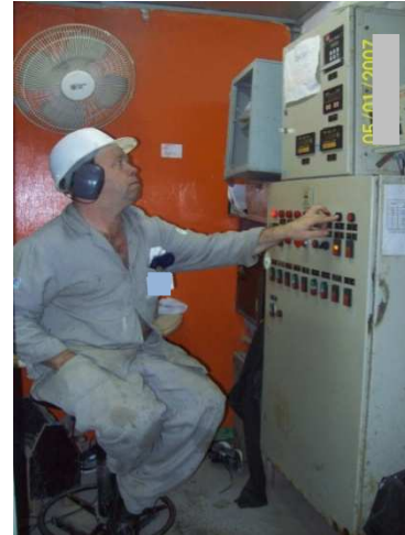
Figura 16: Pannel de comando da central dosadora de concreto
