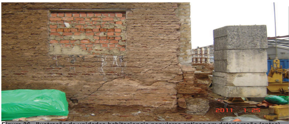
Figura 36 - Ilustração de unidades habitacionais populares antigas em deterioração (antes) Fonte: Tholey (2011).
