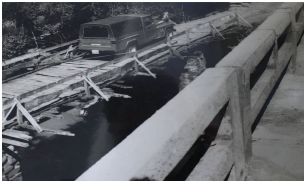
Figura 17 - Vista da substituição de ponte de madeira pela de concreto no interior do município
